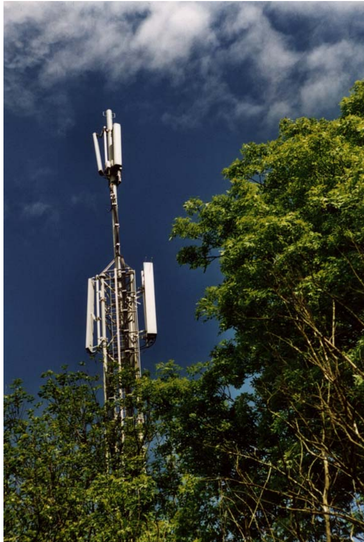
Vue d'un pylône équipé de 6 antennes directives
